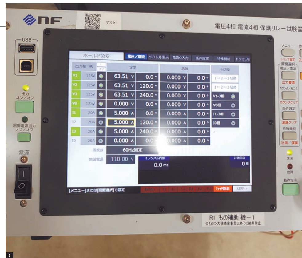
1.導入した電圧4相電流4相保護リレー試験器 2.3.保護リレー試験器を使って、試験している様子 4.試験器室兼試験器倉庫
