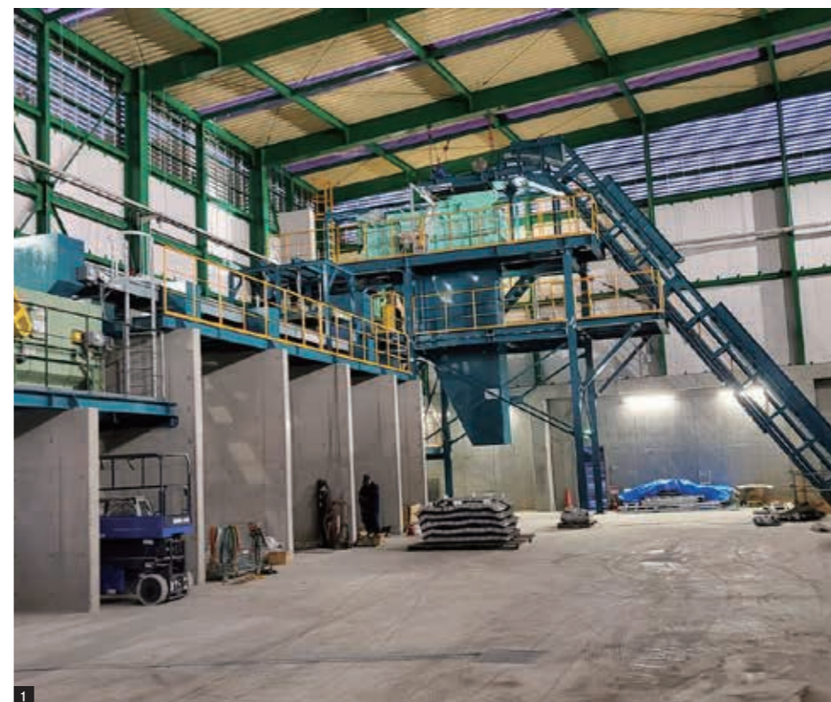
1 同社が製造・設置したペットボトルリサイクルプラント 2 導入したメカ式シャーリング 3 導入した形鋼バンドソー
