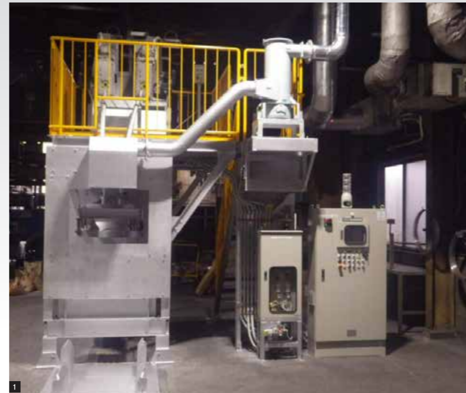
1 導入したMgワイヤー処理装置 2 稼働するMgワイヤー処理装置 3 FCDナックル 4 初見工場
