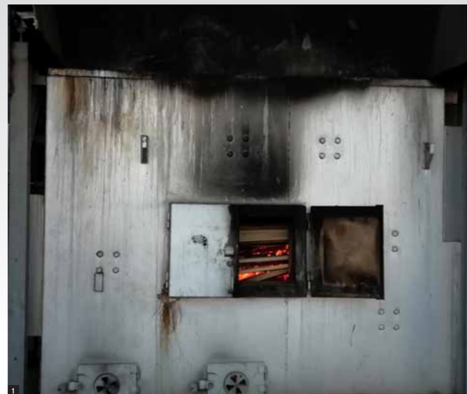
1 導入した木屑焚き温水循環装置 2 木材乾燥機の制御盤 3 製材所の様子
